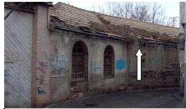
Hundimiento de cubiertas y aleros. Calle Tabernica.
