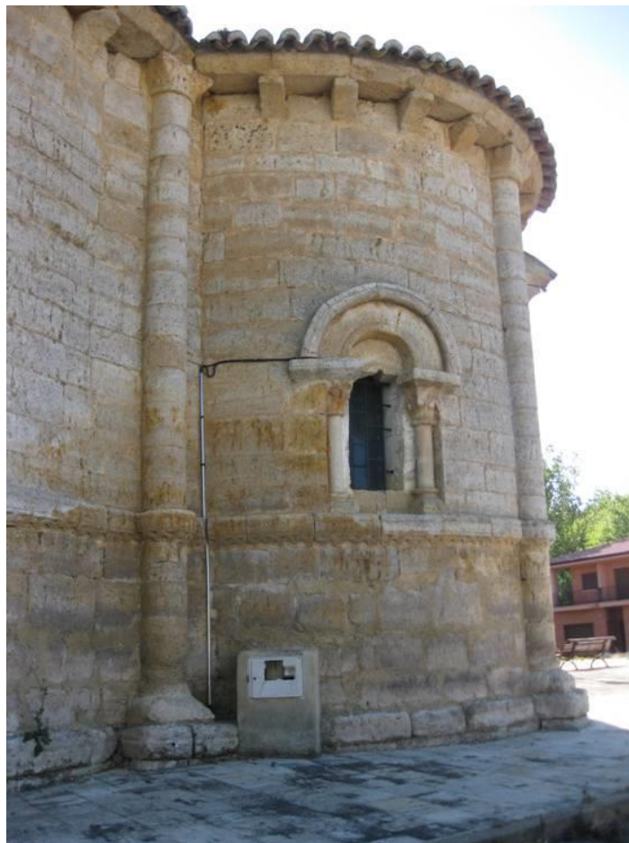
Anclaje de instalación eléctrica en el ábside románico de una iglesia rural, con el agravante de que se empotra para uso del propio templo.
